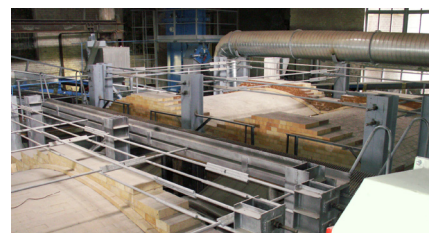
Свод печи и регенератор
